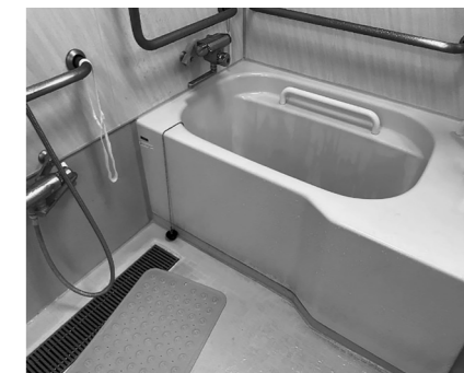
手すり等が整備された浴槽で、 家での入浴のための訓練をします
